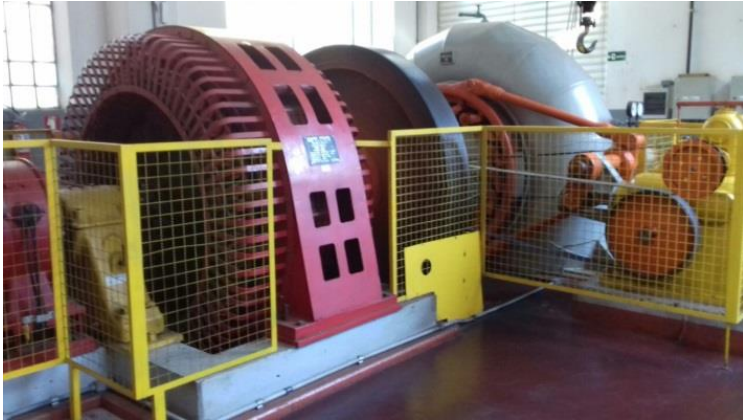
Figura 01 - gerador, Usina do Lobo, acervo do autor.
